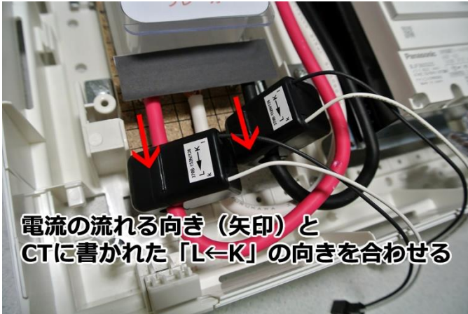
(写真) CTの取り付け例。(単相3線式の分電盤)
